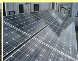
(太陽光パネル)
